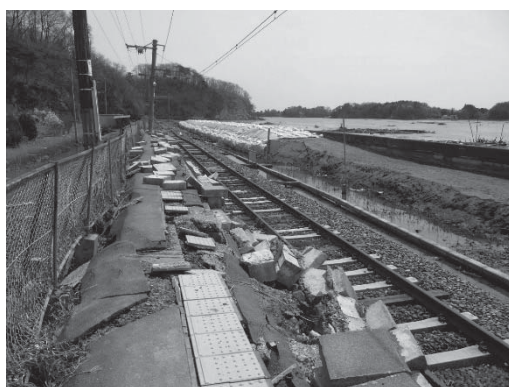
写真7 陸前富山駅の被害の様子 宮城県松島町 (2011年4月21日)
